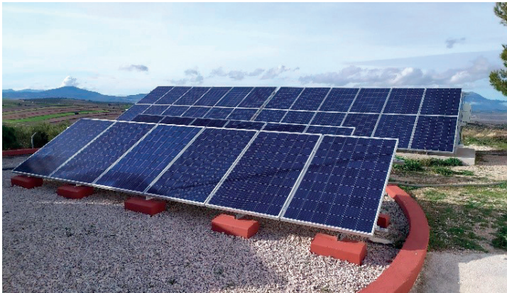
Figura 25: Instalación fotovoltaica para abastecimiento de las instalaciones.
