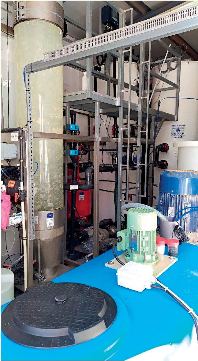
Figura 26: Depósito de nutrientes y vista de la planta potabilizadora.
