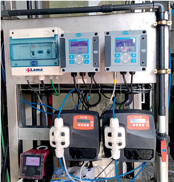
Figura 20: Bombas inyectoras de nutrientes y medidores multiparamétricos.
