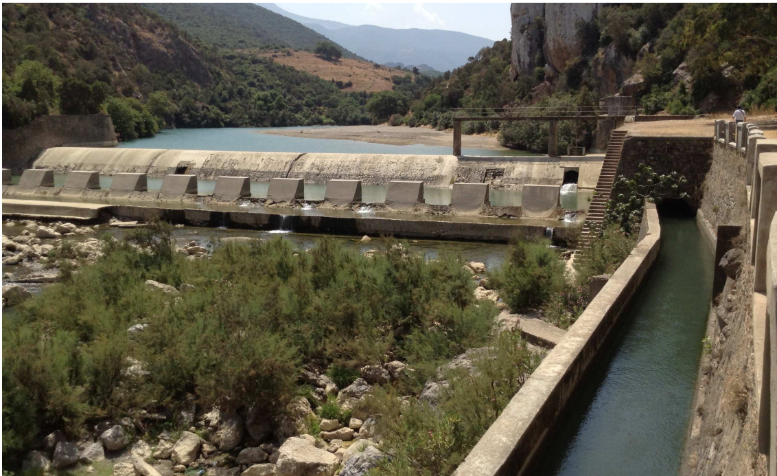
Fig.14. Presa de Oued Laou.
